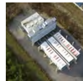
Haßfurt 1,8 MW Leistung, in Betrieb seit 2023
