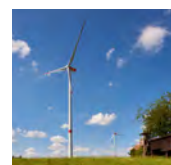
Drackenstein 9,9 MW Leistung, in Betrieb seit 2020
