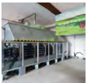
Haßfurt 0,6 MW Leistung, in Betrieb seit 2016
