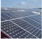
Dasing 1,5 MW Leistung, in Betrieb seit 2006
